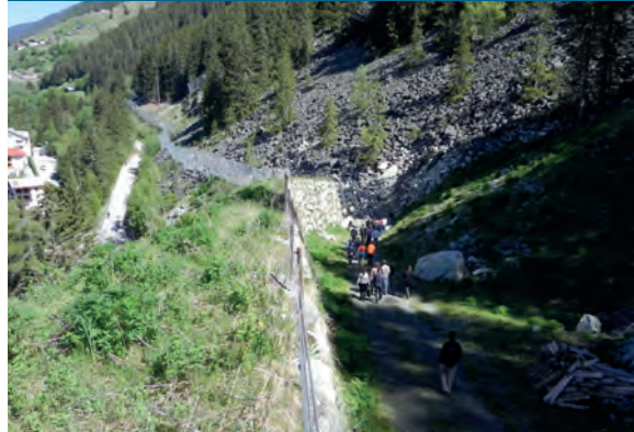
Abb. 4: Technische Steinschlagschutzmaßnahmen (flexible Netze, Dämme) zum Schutz des Siedlungsraums am Gröblefelssturz im Paznauntal (Tirol)
