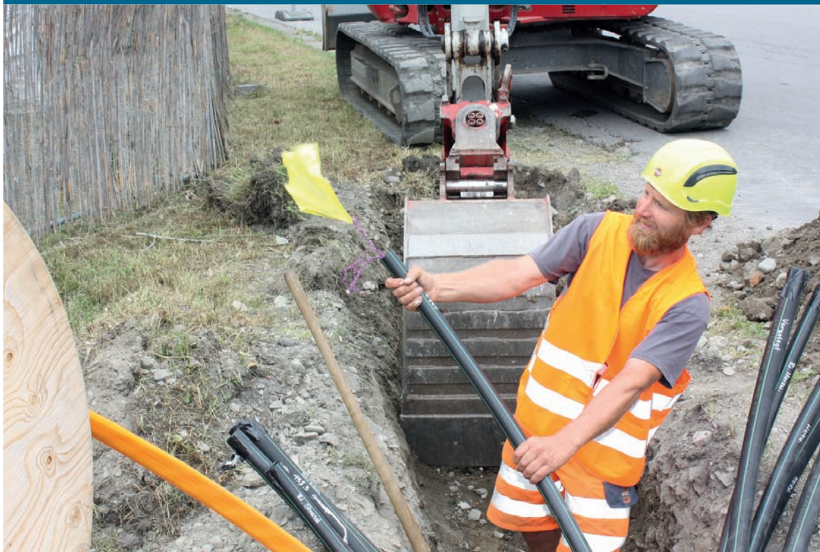
Abb. 9: Breitbandausbau in der Stadtregion Lienzer Talboden im Rahmen des Projektes RegioNet
