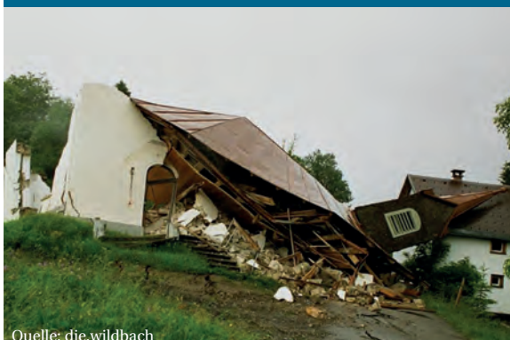
Abb. 3: Rutschung Kirche Rindberg
