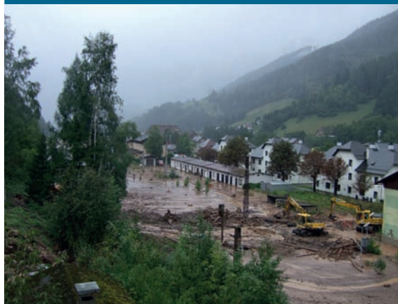
Abb. 6: Aufräumarbeiten nach schweren Schäden an der Infrastruktur
