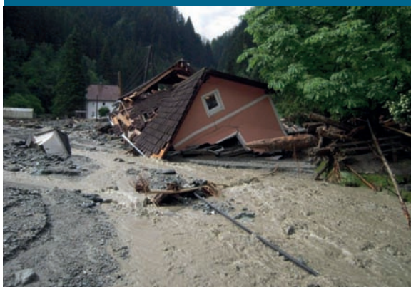
Abb. 1: Gebäudeschäden durch Hochwasser
